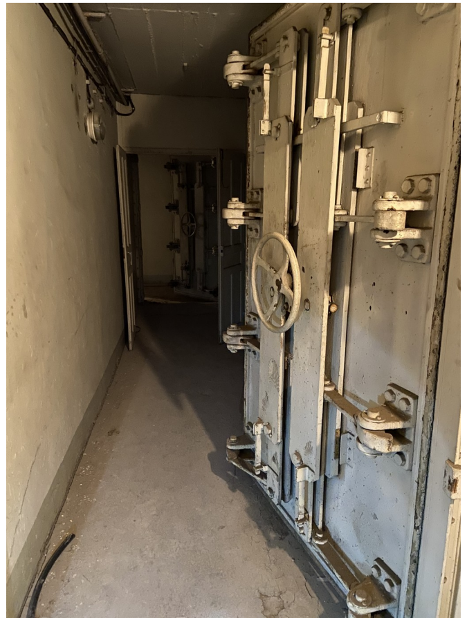
Portes blindées du PC enterré ©Pierre-Yves Cormier
